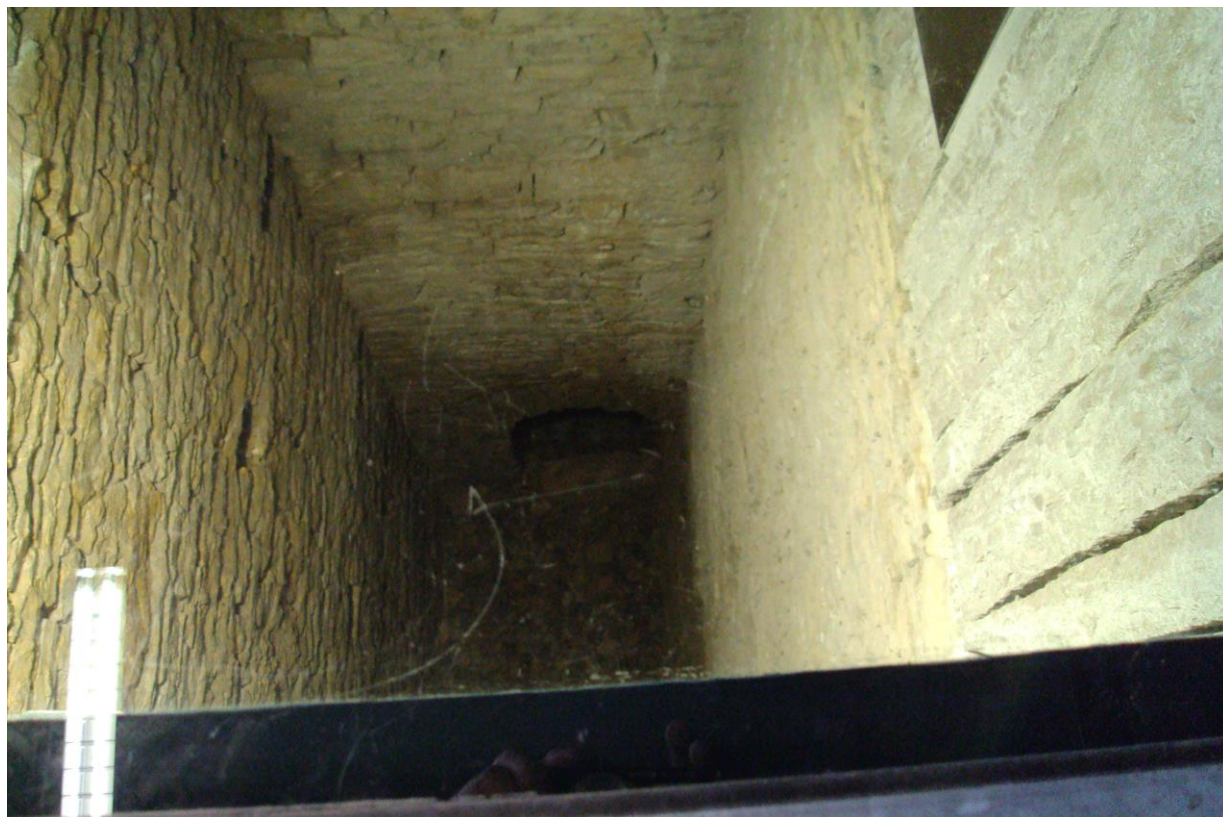
Fig. 3 Lors de la construction du bâtiment Swisscom à la rue des Draizes, l'excavation du sous-sol a fait apparaître sous 6-8 mètres de remblai l'aqueduc dont la plus grande partie est effondrée. Le regard a été recouvert d'une plaque de verre pour que l'on puisse le voir et il est maintenant dans un bureau au sous-sol. En regardant bien cette photo, on aperçoit au fond l'ouverture de l'aqueduc.
